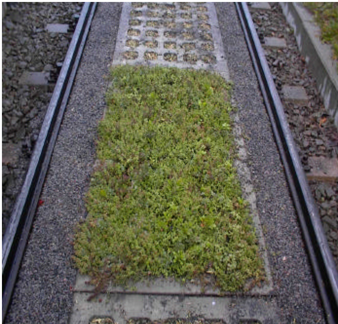
Bild 3: Für Ausstellungszwecke intensiv vorkultivierte Gleiseindeckplatte nach sieben Monaten Vegetationsentwicklung, Zustand im Oktober 2002
